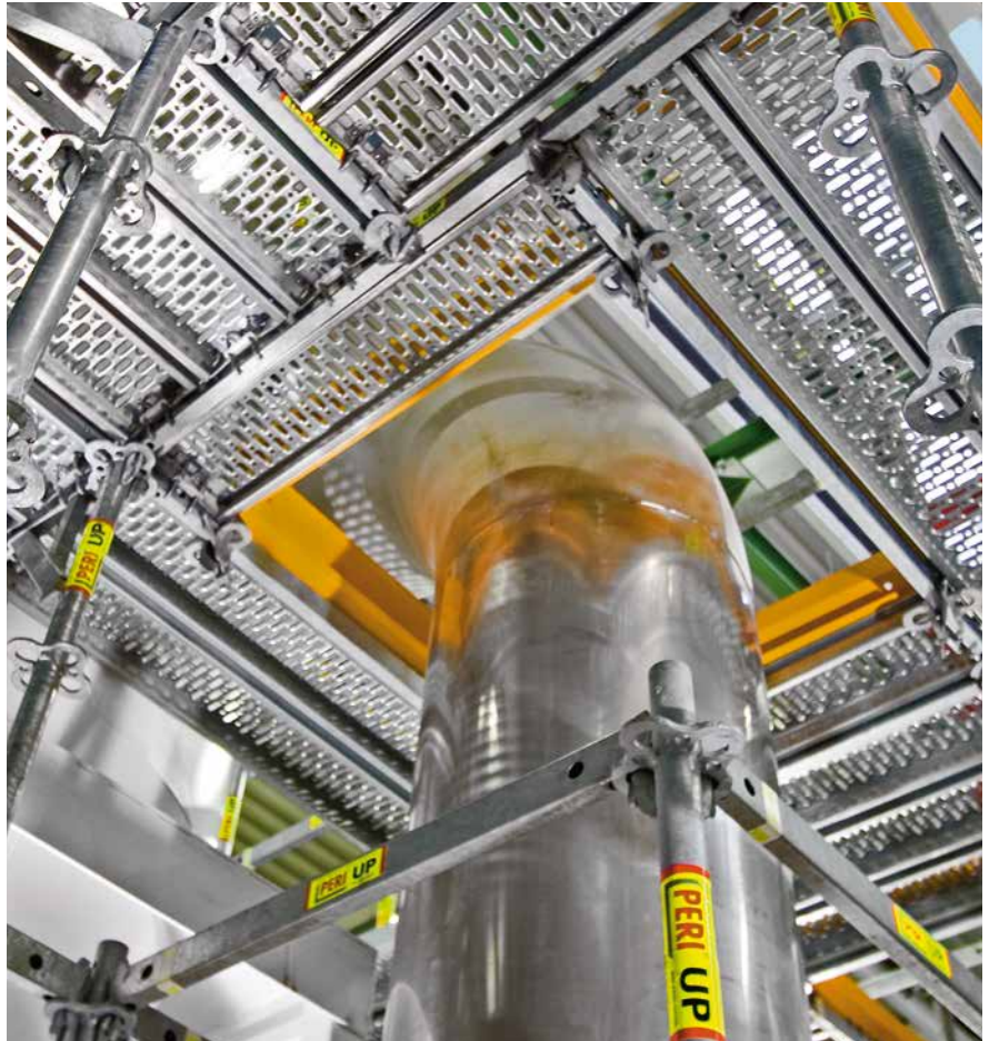
Le changement de direction des plateaux en trame de 25 cm offre une énorme capacité d'adaptation, et ce, presque sans raccords de tubes.
