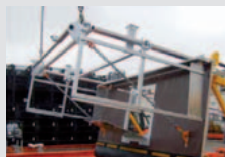
La sécurité MXP possède une barre de levage afin de préserver les garde-corps lors de cette phase de manutention.
