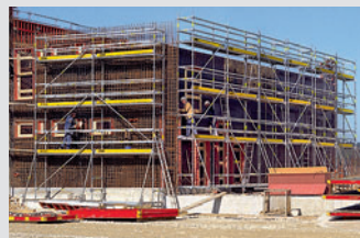
Consoles de travail bâtiment
